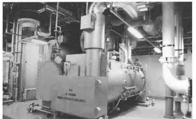
ターボ冷凍機（放映された映像より抜粋）
