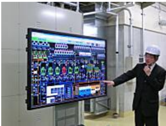
スカイツリー地下冷暖房システム
